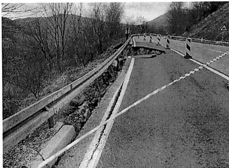
Pojava klizišta na desnoj kolovoznoj traci
