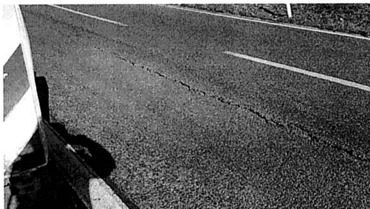
Deformacije na desnoj kolovoznoj traci niže od pokrenutog klizišta (pravac Konjic)
